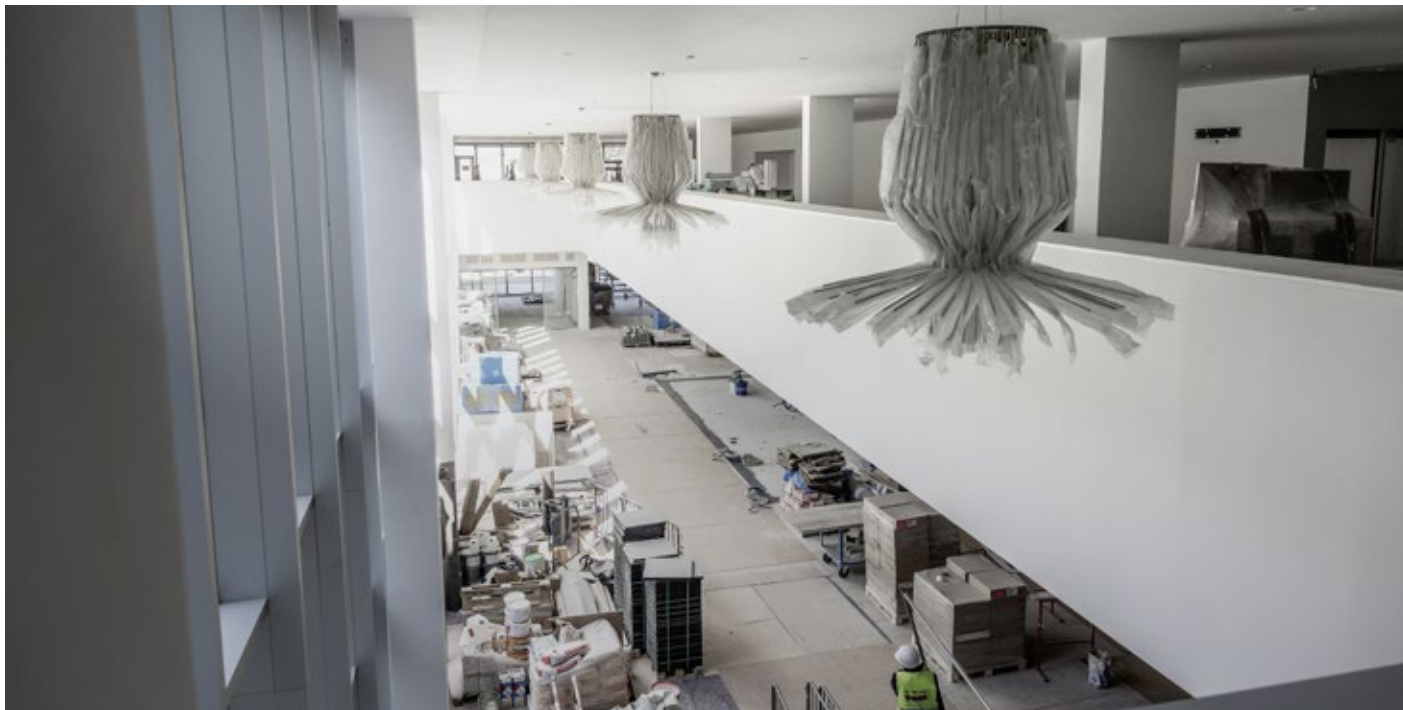
Des volumes généreux et de la lumière naturelle accueilleront le visiteur dès le hall d'entrée.
